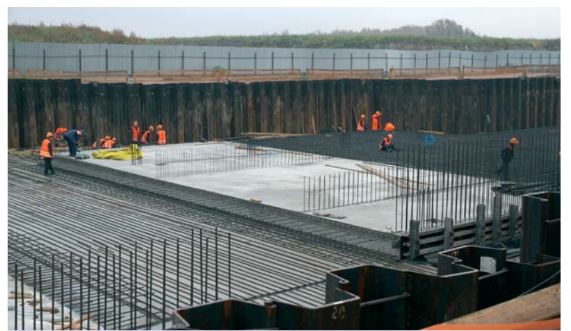
На площадке будущего станционного комплекса «Южная» продолжаются работы нулевого цикла. Строители Семнадцатого управления закончили гидроизоляцию и сейчас выполняют армирование оснований фундаментов и подколонных выпусков в котлованах № 1 и № 2. Скоро начнется демонтаж шпунтового ограждения котлованов. Следующий этап строительства станции «Южная» – возведение стен котлована и железобетонных конструкций служебных помещений, соединение портальной части с тоннелем
